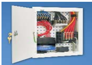
Εικόνα 17: Κεντρικός κατανομητής οικίας με modem/router και παροχή ρεύματος
