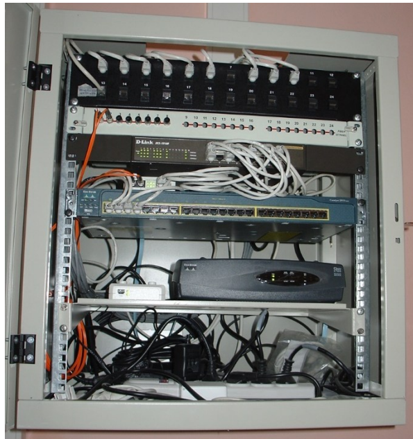
Εικόνα 5-6. Τηλεπικοινωνιακό ικρίωμα (rack) τερματικού κόμβου με εσωτερική συσκευή ασύρματης σύνδεσης, δρομολογητή και δύο μεταγωγείς.
