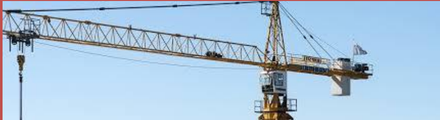
Δομικός Γερανός Πύργου
