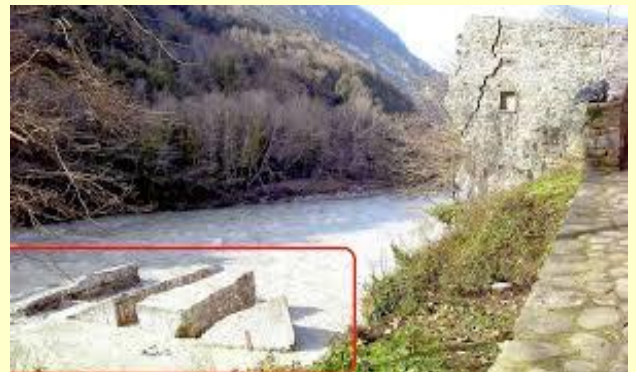
Εικόνα 13 : Στην παραπάνω εικόνα μπορούμε να δούμε κάποια κομμάτια γέφυρας τα οποία έχουν πέσει στη θάλασσα.
