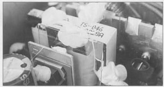
Σχήμα 10. Μεταξύ του μετασχηματιστή και των ψυκτών, τοποθετούνται μονωτικά φύλλα.
