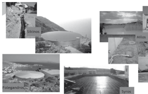
Εικόνα 5: Εγκαταστάσεις ανάκτησης βρόχινου νερού στις Κυκλάδες
